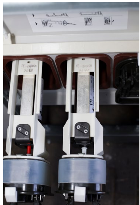
Povezave v notranji stikalni napravi, primer:
