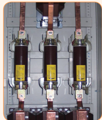
Położenie wkładek topikowych zamontowanych na zewnątrz.*
